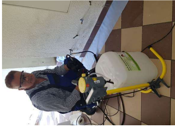
Die Abbildungen zeigen den Ablauf der Erstellung einer nachträglichen Horizontalsperre durch einen zertifizierten Fachbetrieb.
