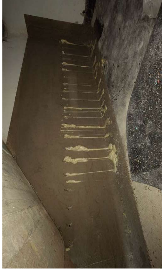
Wasser dringt in den Keller ein.
